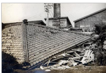
▲倒壊した家屋 50022
