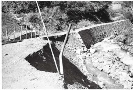
昭和36年 台風18号による被害 (第二室戸台風)
